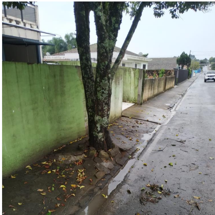
Figura 8 - Raiz da árvore deformando a calçada. FONTE: Autoria própria, 2021.
